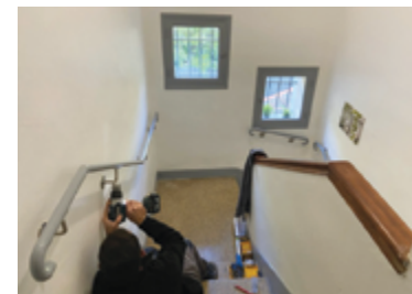
Accessibilité Porte d'entrée refaite Nettoyage de la cour Fabrication et pose d'une rampe
